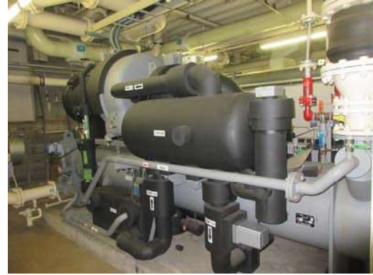
ターボ冷凍機
