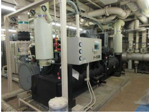
ターボ冷凍機
