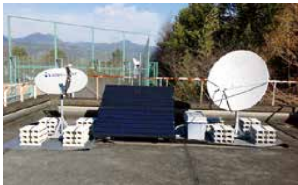
自立型防災通信ステーション
