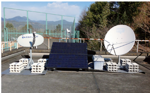
自立型防災通信ステーション
